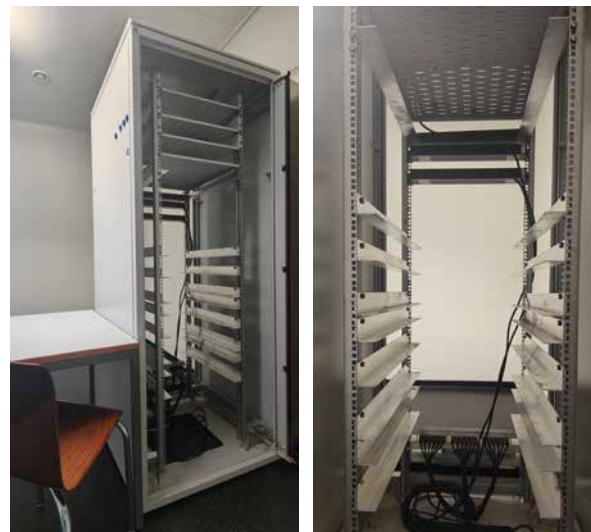
Bild: einer der beiden stillgelegten Serverräume
